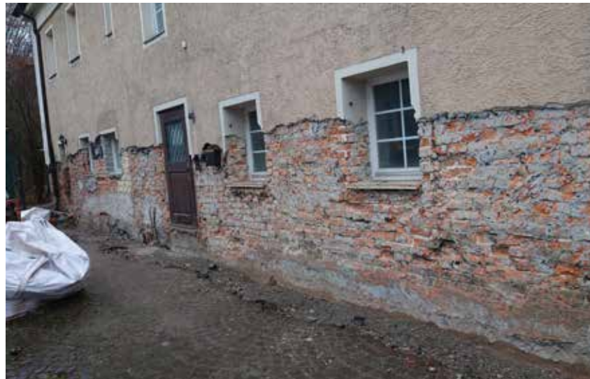
Hier gibt es viel zu tun: Die Sanierungsarbeiten am historischen Waschhaus haben begonnen.
